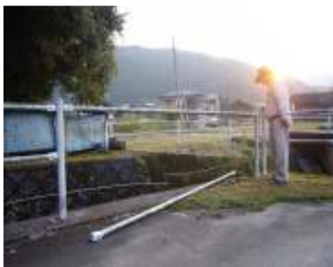
<河川への転落防止フェンスが破損 ～高城川支流>
