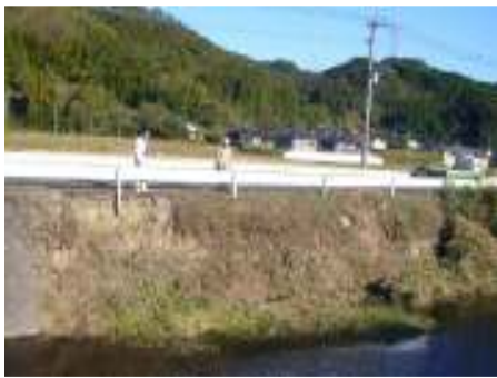
護岸クズレにより県道のガードレールがぶら下がっていました。
