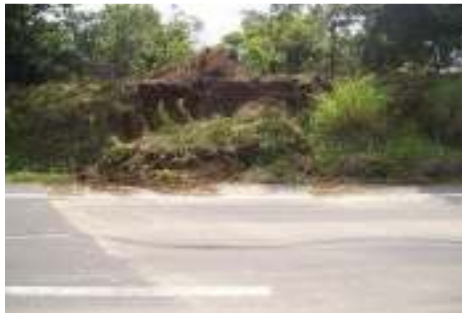
<県道の法面クズレ>
