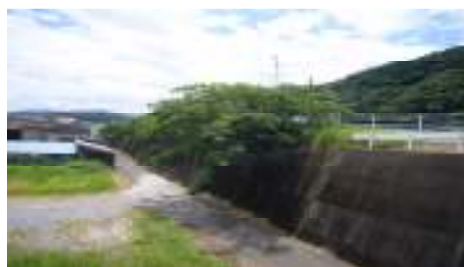
<市街地の県道法面に草木が繁茂>
