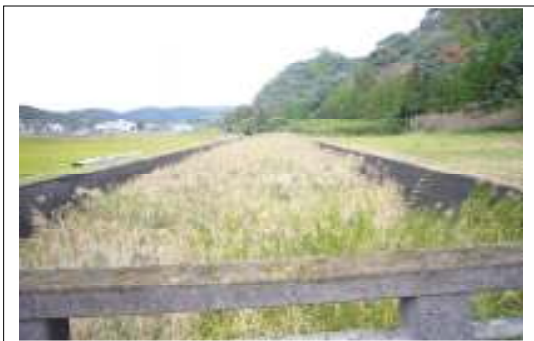
<湯田川：三月田橋上流 ～現況：水面が、まったく見えません。> ※湯田小・中学校付近も要望済みです。
