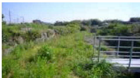
<勝目川の堤防改修 ～ガレキもあり草払い等が困難でした。>
