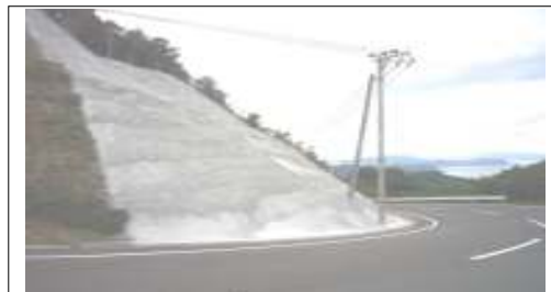
【甑架橋建設と同時に、災害復旧工事も 着実に進められています。 ～下甑島：鹿島町～下甑町】
