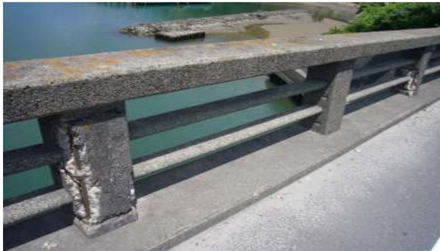
< 塩害、老朽化で鉄筋がむき出しの船間橋（港町）～H22. 8月 >
