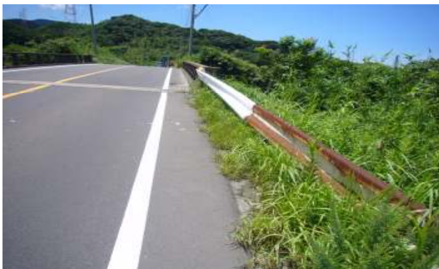
< 「歩道」が未整備の船間橋付近の臨港道路～船間島方向を見る > (H22. 7月)
