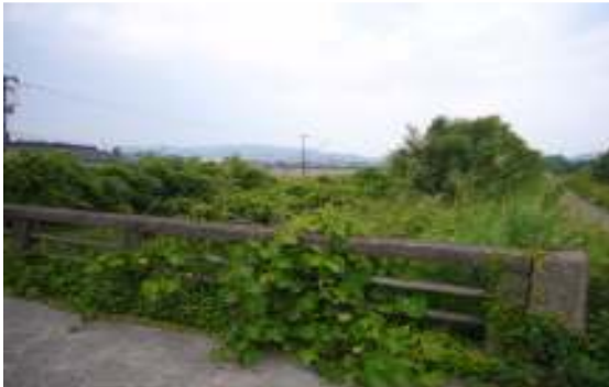
<堤防に草木が繁茂して、 橋にまで、からまっていた。>
