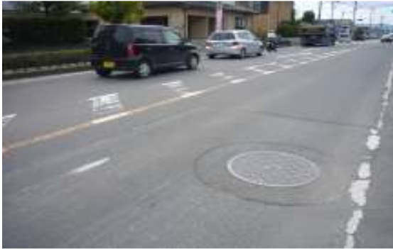
<マンホールと路面の段差が、 ありました。>
