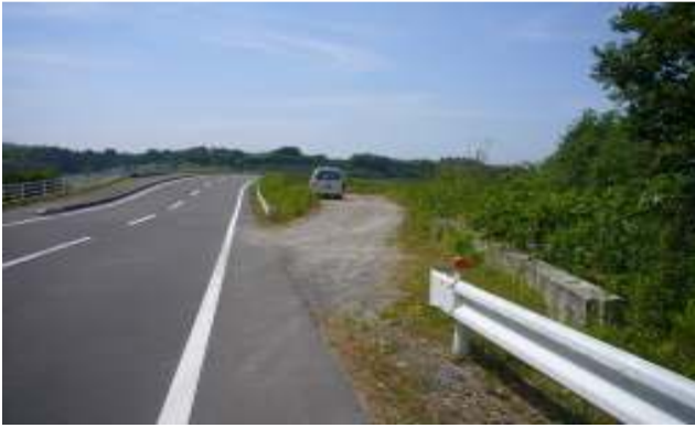
＜左岸側の堤防（護岸）が低い状態 吉野山ポンプ場下流 ～H21. 6月＞
