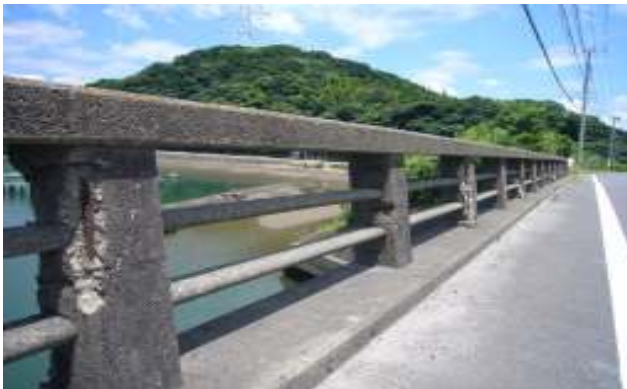
＜塩害、老朽化で鉄筋がむき出しの状態 ～H22. 8月＞
