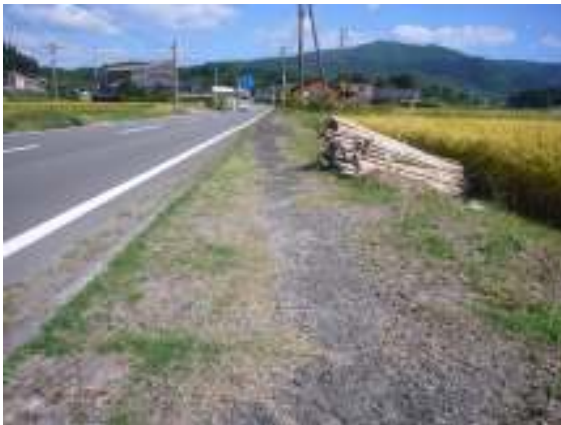
< 通学路歩道の舗装が荒れて、 雑草も繁っていました。 >
