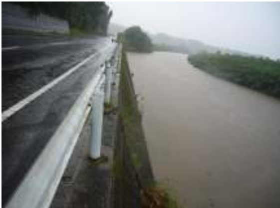
< 樋脇川の堤防のかさ上げ要望 ~ 洪水時の吉野山ポンプ場下流 >
