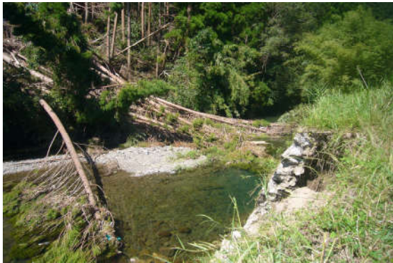
(H27 台風 15 号による風倒木、堤防損壊)
