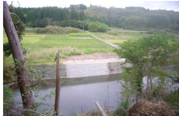
(高城川～城上地区・八幡地区)
